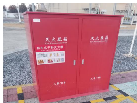
(6) 站内消防设施
