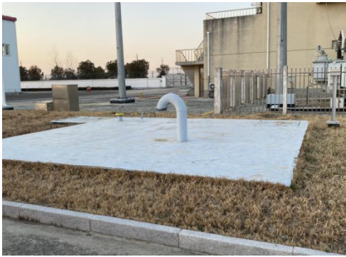
(2) 地埋式防渗污水池
