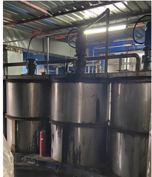
胶料暂存间（物料管道输送）
