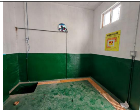
内部分区贮存标识牌
